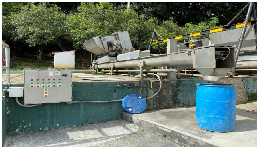
Ilustración 3 Rejilla automática y extracción de residuos
