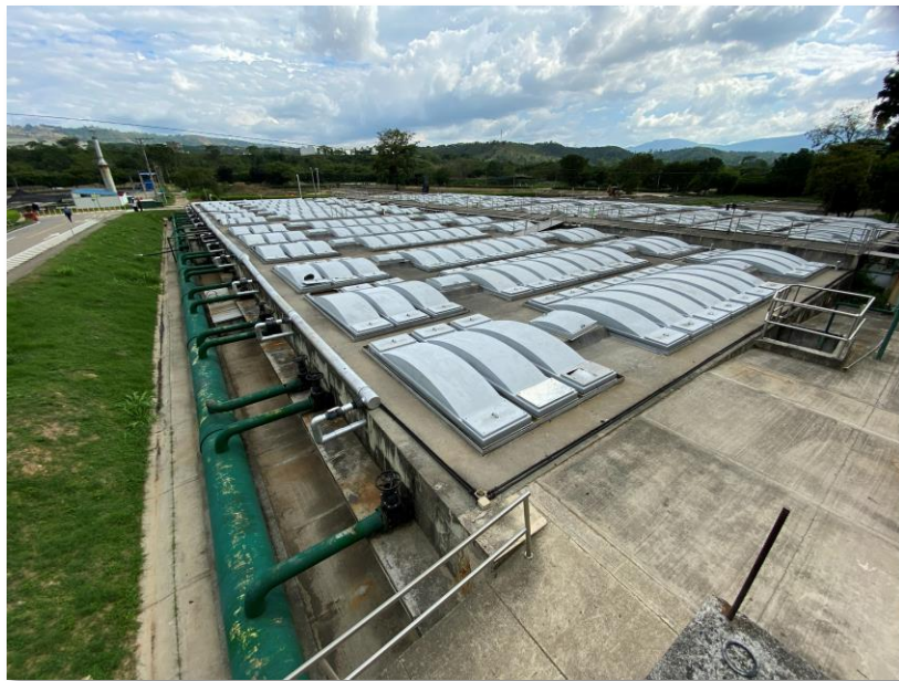
Ilustración 6 Reactor UASB No. 5
